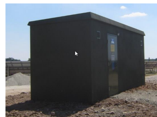
Exemple de poste de conversion
