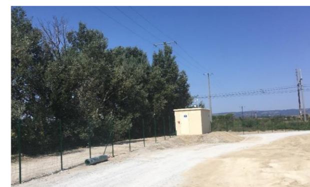
Exemple d'un poste de livraison
